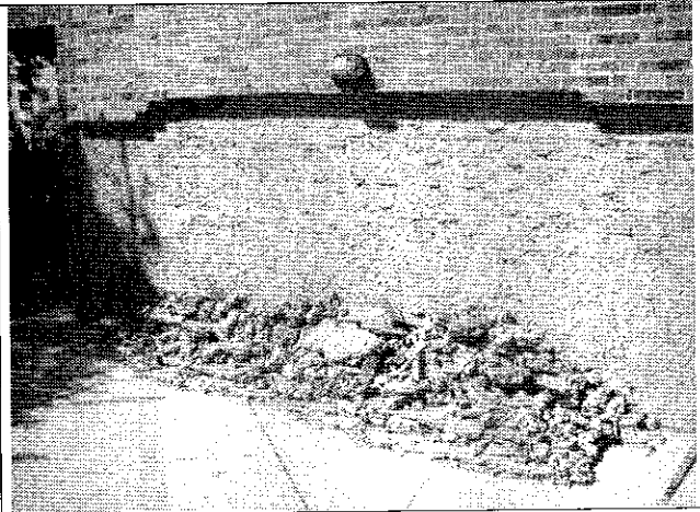
Foto 2. Detalle del desprendimiento de fachada en el costado sur de una de las torres del conjunto residencial.
