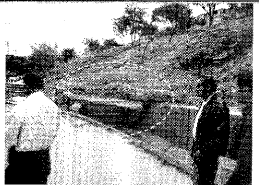
Fotografía 14. Vista de las afectaciones observadas sobre el muro en concreto ubicados en la parte baja del sector evaluado en el presente informe, perteneciente al barrio Candelaria La Nueva III Sector.
