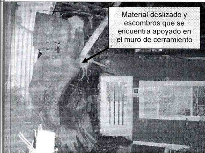
Foto 11. Material deslizado y escombros que se encuentra apoyados en el muro de cerramiento del predio de la Calle 69M Sur # 18M-50 del Barrio Villa Gloria en la Localidad de Ciudad Bolívar.
