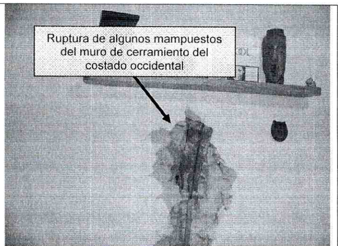
Foto 12. Ruptura de algunos mampuestos del muro de cerramiento del costado occidental de una de la unidad habitacional del segundo nivel del predio de la Calle 69M Sur # 18M-50 del Barrio Villa Gloria en la Localidad de Ciudad Bolívar.
