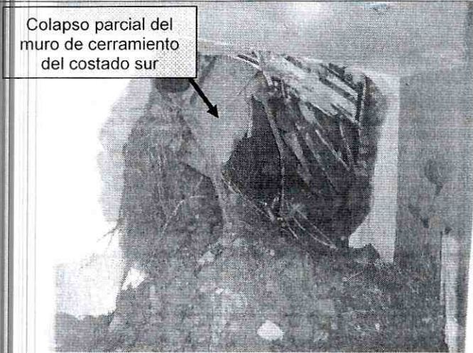
Foto 9. Colapso parcial del muro de cerramiento del costado sur del predio de la Calle 69L Bis Sur # 18M-55 del Barrio Villa Gloria en la Localidad de Ciudad Bolívar, donde se observa ingreso de material deslizado y escombros
