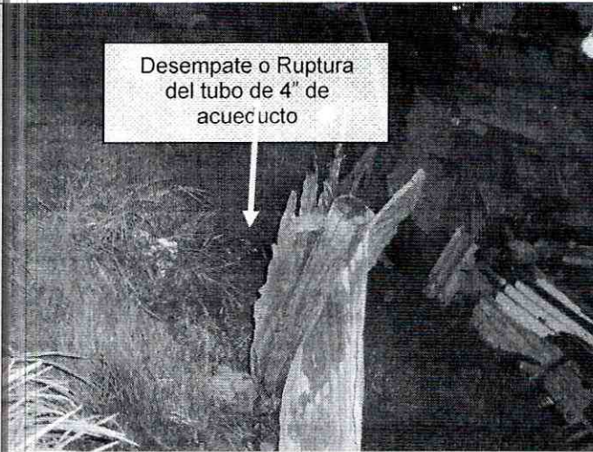
Foto 1. Desempate o Ruptura del tubo de 4" de acueducto en el Barrio Villa Gloria de la Localidad de Ciudad Bolívar.
