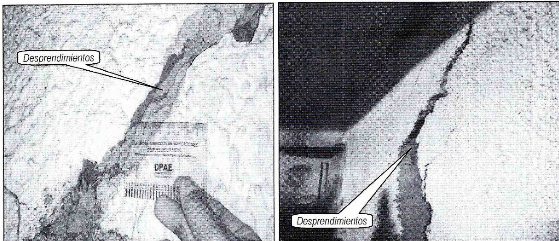
Fotografía 3 y 4. Vista de los desprendimientos del costado sur del Edificio del Consejo Seccional de la Judicatura de Bogotá ubicado en la Calle 85 No. 11-96 Localidad de Chapinero
