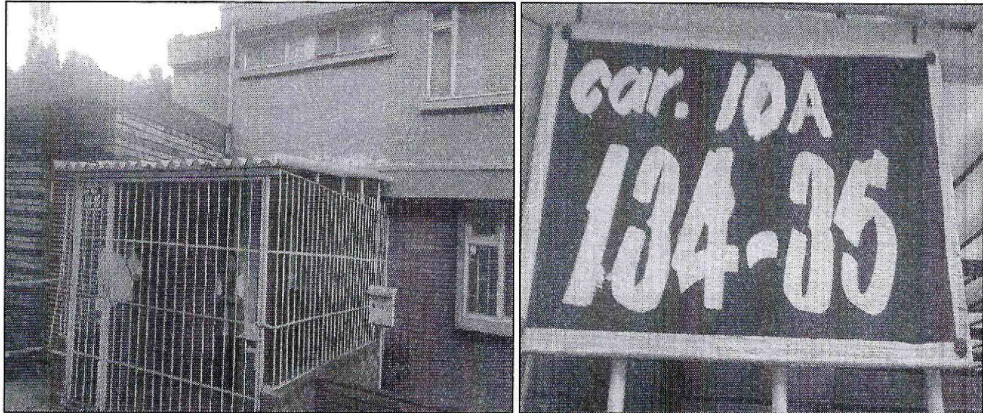
Fotografía 7 y 8. Vista del predio colindante por el costado norte a la obra de construcción, el cual en la actualidad presenta lesiones de tipo mecánico leves. Carrera 10A No. 134-35 Sector Catastral Lisboa en la Localidad de Usaquén
