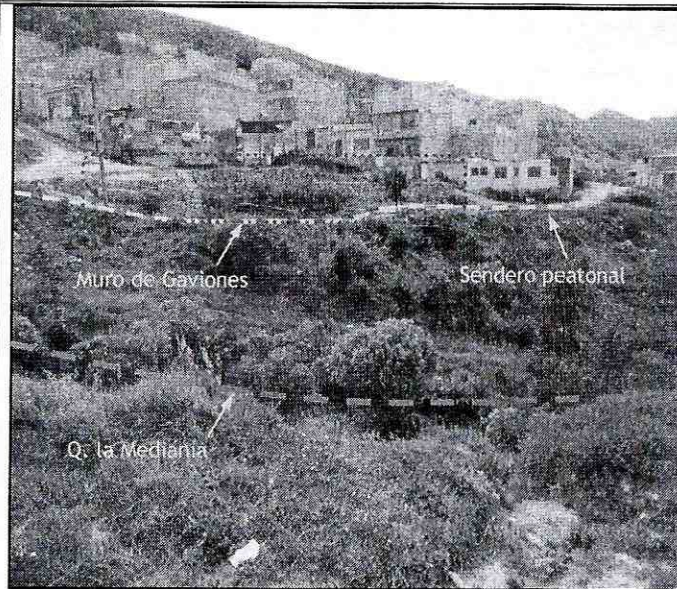
Fotografía 3. Vista del proceso de remoción en masa evaluado a la altura de la Transversal 8D Este entre la Calle 110 Sur y la Calle 111A Sur, en el barrio el Portal del Divino en la localidad de Usme. Se observa el sendero peatonal afectado y el muro en gaviones que se localiza en el sector.
