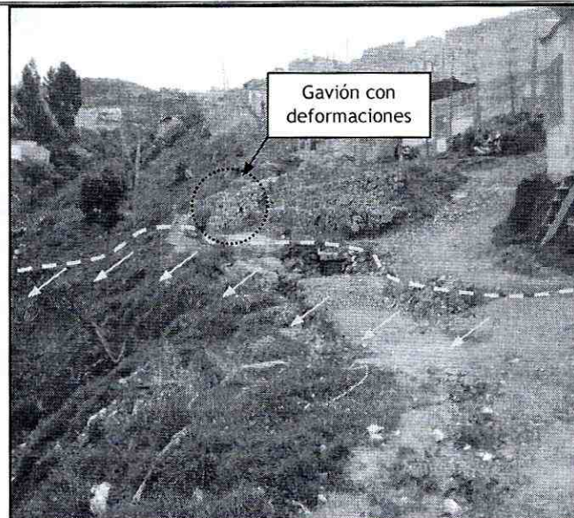
Fotografía 8. Deformaciones en muro de gaviones ubicado hacia la parte alta del proceso de remoción en masa evaluado y ubicado a la altura de la de la Transversal 8D Este entre la Calle 110 Sur y la Calle 111 Sur, en el barrio el Portal del Divino en la localidad de Usme.
