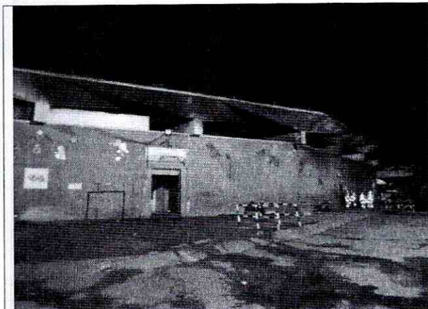
Foto 1. Vista general de la fachada del costado occidental de la edificación donde se presentó el incendio (Plaza de mercado de PALOQUEMAO), ubicado en la Av. Calle 19 No. 25-04.
