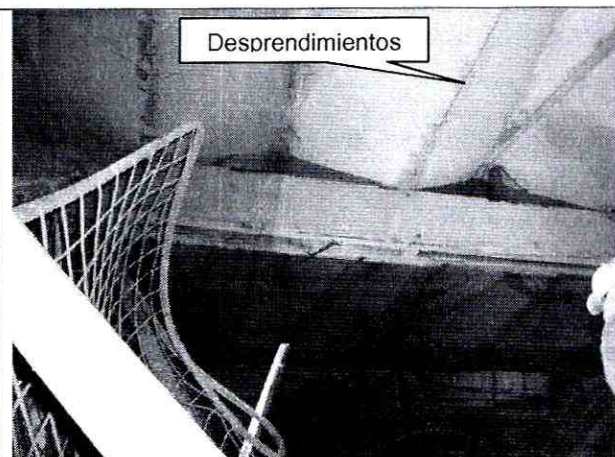
Foto 4. Vista de una fracción de la cubierta en placas de concreto de la zona donde se presentó la conflagración; se observa desprendimientos del concreto de placas y vigas que exponen el acero de refuerzo y se observa escombros de las sub-estructuras metálicas.
