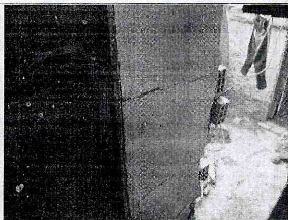
Foto 4. Detalle de las grietas en el muro de la unidad estructural donde se ubica la cocina.
