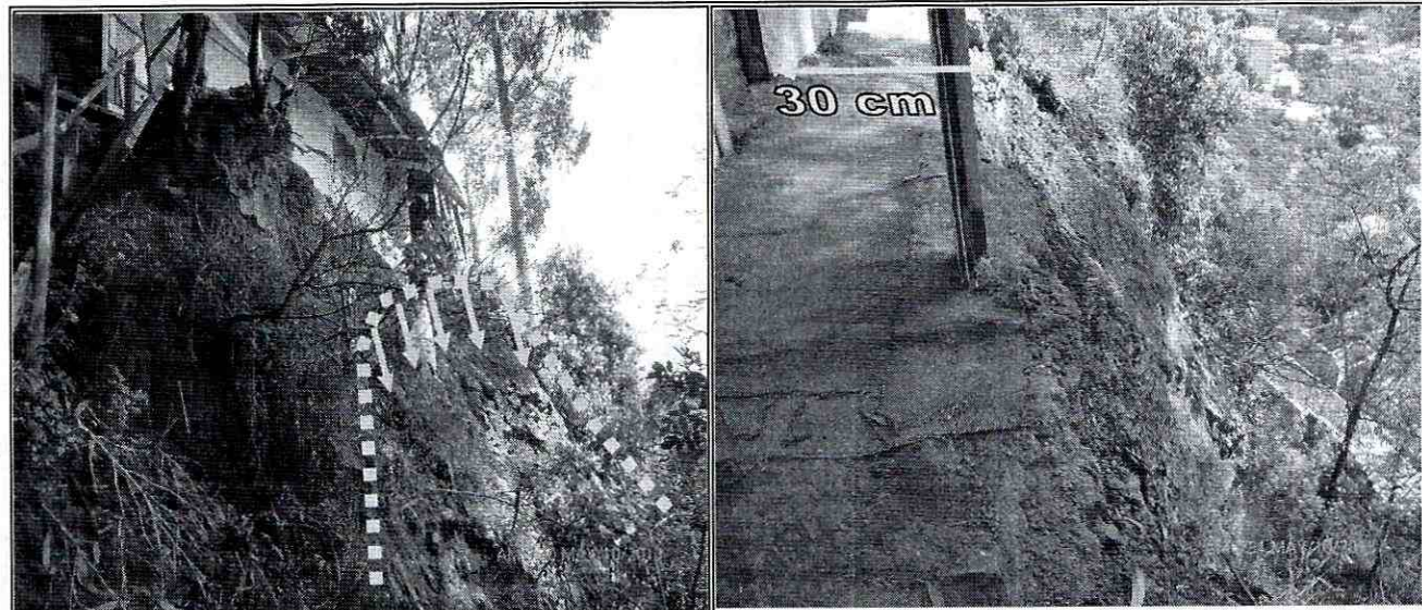
Foto 5 y 6. Se observa zona donde se presentaron los desprendimientos de material, lo que podría desconfiar parte del suelo donde está apoyada la vivienda con nomenclatura Carretera Oriente 14-24 sur INT 45 A, comprometiendo su estabilidad y habitabilidad en el corto plazo ante cargas normales de servicio.
