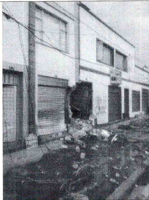
Foto 2. Vista de los daños causados en las redes de servicios públicos. Se observan los cables del poste de energía y el agua que discurre por el andén.
