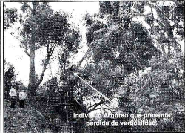
Fotografía 4. Se observa la pérdida de verticalidad del individuo arbóreo, el cual pudiere generar compromiso en la funcionalidad de la zona de patio del predio de la Calle 46D Sur No. 16C-71 Este.
