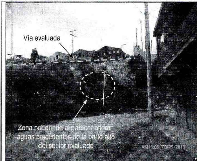
Fotografía 3. Talud de corte por donde al parecer afloran las aguas superficiales procedentes de la parte alta de la ladera y que se filtran por el huevo evidenciado sobre la vía evaluada
