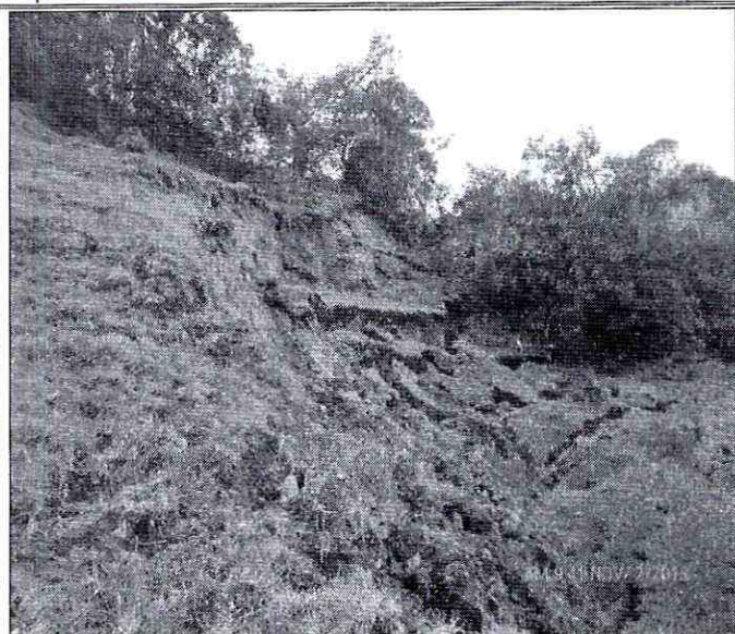
Fotografía 3. Vista del escarpe generado por el proceso de remoción en masa evaluado y que se presentó a la altura del Km 5.2 de la vía que conduce del centro poblado de Betania al centro poblado de Nazareth, el cual presenta una altura de 3m aproximadamente.
