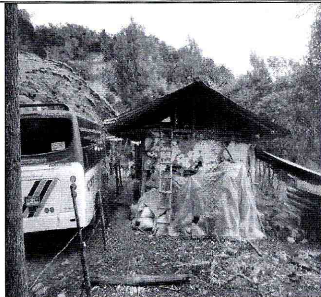
Fotografía 10. Vista del costado Suroccidental de la vivienda de la finca el Pepino, la cual se encuentra construida en bahareque y que presenta un alto grado de deterioro.
