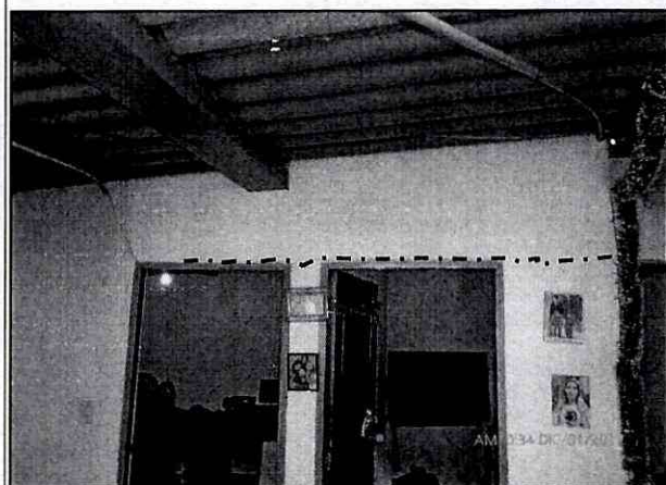
Fotografía 9. Se observa sobre los dinteles de las puertas de dos habitaciones del segundo nivel, localizadas al costado sur-occidental de la edificación emplazada en el predio de la Avenida Caracas No. 40A-29, una fisura de tendencia horizontal, la cual según lo observado no compromete la estabilidad estructural de la edificación.
