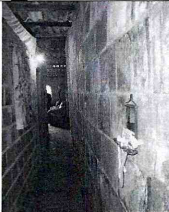
Fotografía 5. Vista de la condición de abombamiento del muro perimetral del costado norte del inmueble identificado como Carrera 18 A Bis No. 78 C-38 Sur (Un. Hab. 1)
