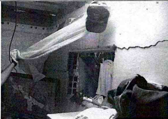
Fotografía 3. Vista del agrietamientos identificados en el muro divisorio existente entre la zona de de ropa y habitación, en el interior del predio de la Carrera 18 A Bis No. 78 C-44 Sur.
