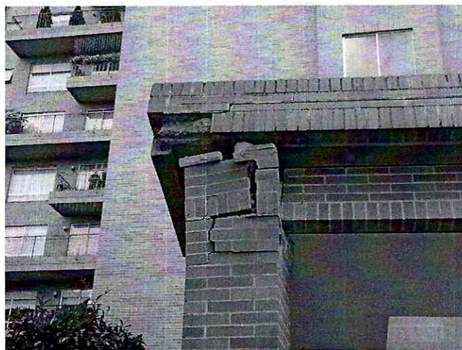
Fotografía 4. Columnas que quedan en pie, hacia el costado de la calle, riesgo de colapso de elementos de mampostería.
