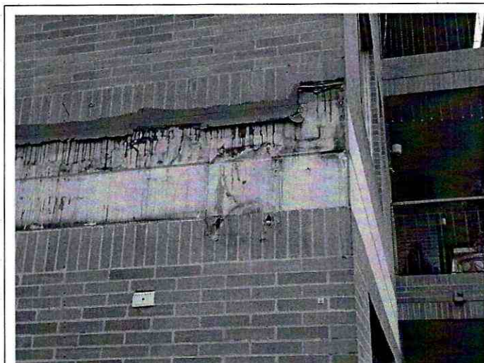
Fotografía 3. Detalle del desprendimiento de los anclajes, parte de ellos estaban montados sobre la mampostería de fachada.
