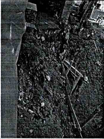
Fotografía No. 3. Se observa el desconfinamiento del suelo, debido a las intervenciones realizadas sobre el costado oriental del predio de la Calle 109A # 18-72.
