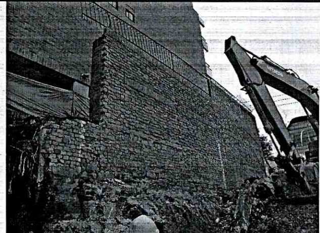
Fotografía No. 4. Vista del muro de cerramiento perimetral ubicado al costado occidental del Conjunto Residencial "El Paseo de San Patricio", el cual sufrió colapsos parciales.
