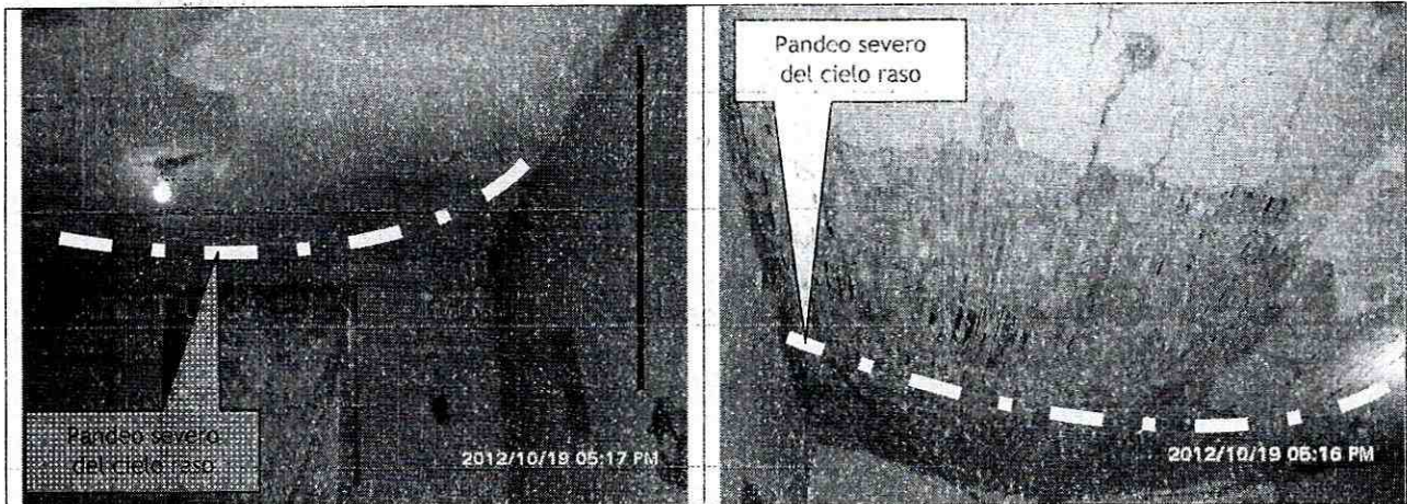
Fotografías 3 y 4. Se observa el pandeo severo del cielo raso y el desprendimiento parcial del mortero de recubrimiento y además existe riesgo de nuevos desprendimientos.
