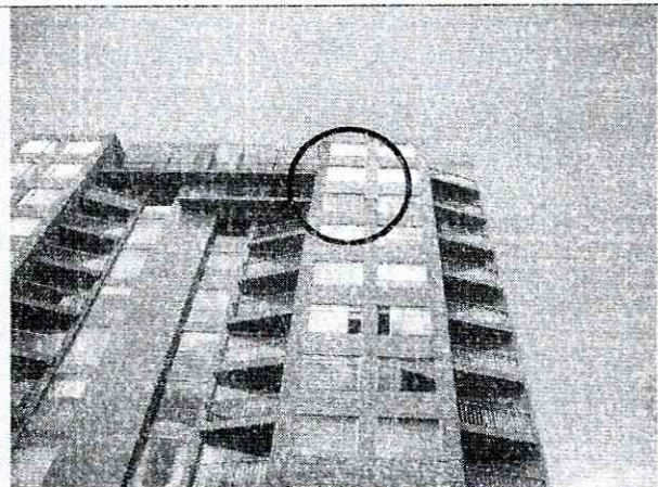
Foto 2. Detalle de una de las zonas donde se ha desprendido el enchape de fachada de las torres.
