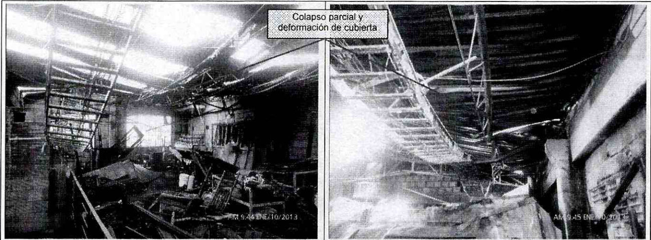
Fotos 3 y 4. Se aprecia el colapso parcial y la deformación de la cubierta del predio con nomenclatura Calle 69B No. 70-71 del Barrio Palo Blanco de la Localidad de Engativá.
