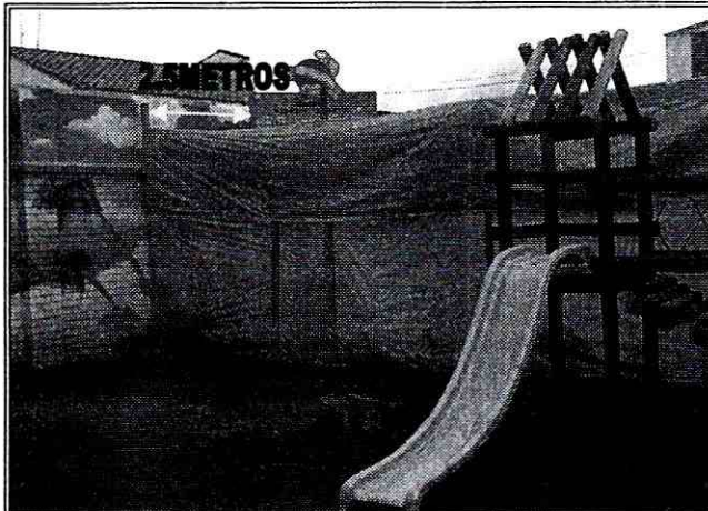
Foto 3. Se observa afectación de 2.5 metros aproximadamente de la zona del patio en la parte interna del predio de la carrera 18A#151-36 donde funciona el Jardín Infantil Semillitas de Amor.
