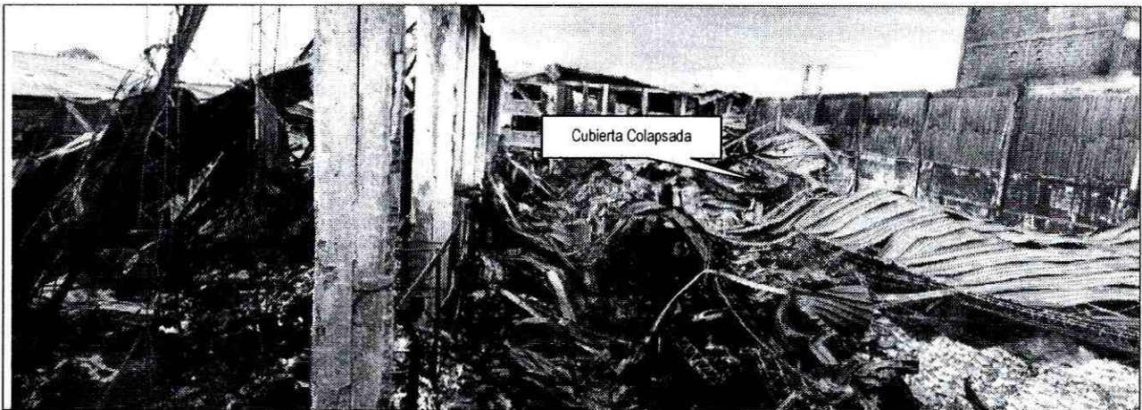
Foto 2. Vista general hacia el costado posterior de la Calle 66A # 95-35 y Calle 66A # 95-11, donde se presentó el incendio. Se observa el colapso total de la cubierta.
