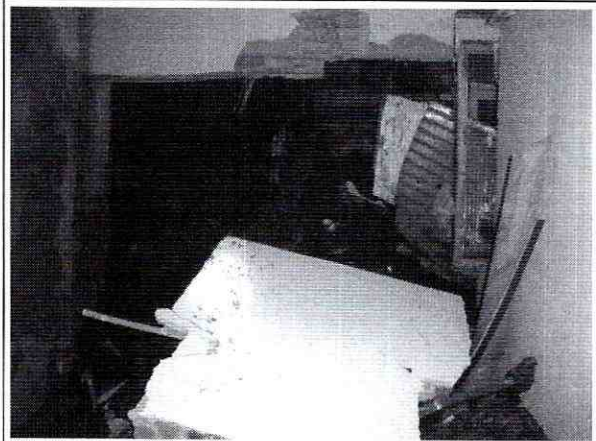
Fotografía 2. Colapso del muro de cerramiento en la habitación posterior de predio de la Cl. 162 No. 4 A – 03, el cual causó la pérdida de los enseres que se encontraba en la misma. Se presentó igualmente colapso parcial de cubierta.
