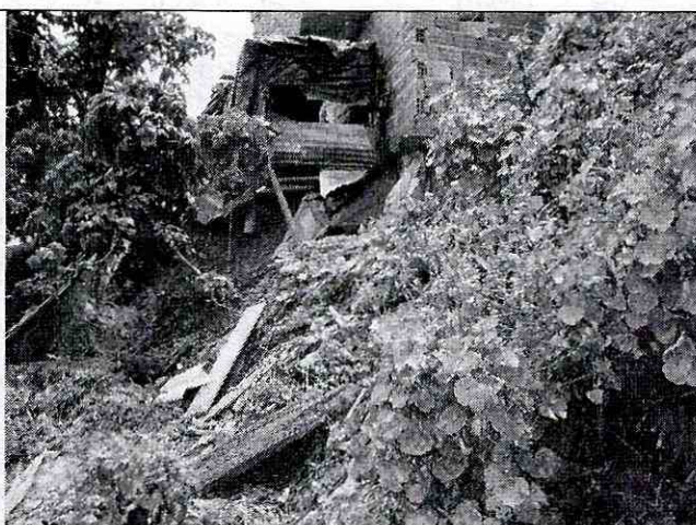
Foto 4. Vista del patio posterior del predio que sufre afectaciones y referencia de la habitación restringida.
