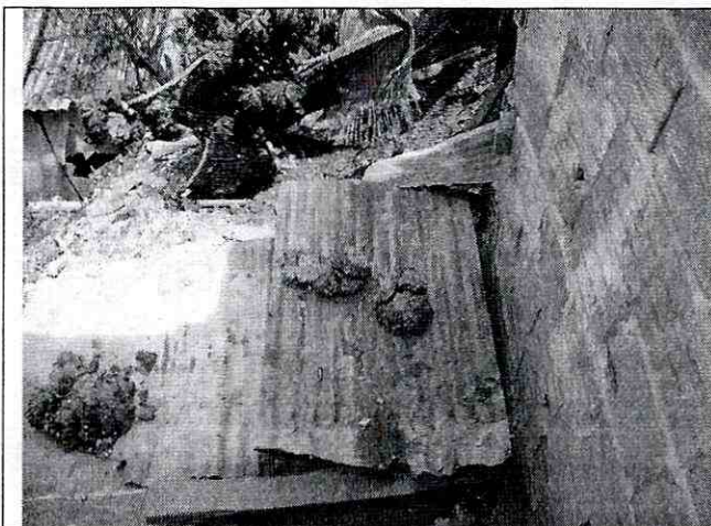
Foto 1. Detalle de la zona del pasillo posterior que ha colapsado luego de la pérdida de su suelo de cimentación.
