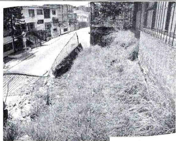
Fotografía 5. Vista de la parte del talud de relleno, donde se presentó el deslizamiento de material y donde se identificó un escarpe de 70 cm en altura, ubicado a una distancia cercana a un metro de la estructura de la vivienda de la Calle 46 No. 4-18.
