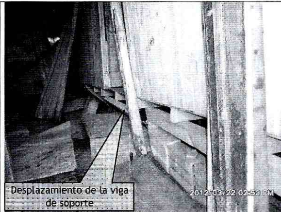
Foto 4. La vivienda de la Calle 81 D No. 18 C - 23 Sur presentó un desplazamiento horizontal, y las vigas de soporte se desplazaron de los pilotes de cimentación palafítica.
