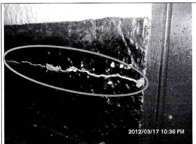
Foto 8. Se observa grieta a lo largo del muro que conforma los depósitos del costado oriental del edificio.
