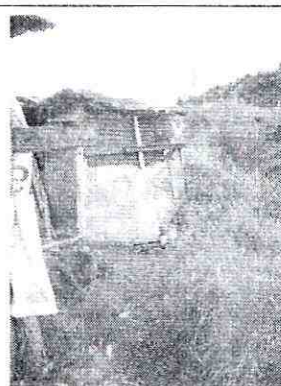
Fotografía 2. Vista de la parte posterior la vivienda habita la Señora Martha Cotrina Cotrina, inmueble localizado entre los Lote 5 y 18 de la Manzana 27 según el Concepto Técnico No. CT-5231 y donde se han identificado procesos retrogresivos del PRM3
