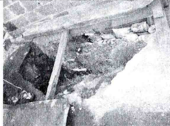
Foto 2. Vista de la losa de contrapiso al costado occidental (posterior) del predio ubicado en la Carrera 18D Bis # 81A-35 Sur. Se observa el colapso parcial de la losa en concreto y el muro en piedra pegada en una longitud mayor a 1m.
