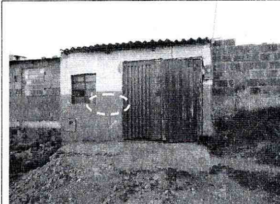
Foto 1. Vista de la fachada de la edificación emplazada en el predio con de la Carrera 18D Bis # 81A-35 Sur, Barrio El Tesorito de la Localidad de Ciudad Bolívar. Se presentan grietas en el muro de fachada.
