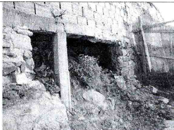
Foto 6. Vista al costado Norte (posterior) del predio de la Calle 81B Sur # 18D-22. Se observa el colapso parcial del muro en piedra pegada que confina el suelo de relleno donde se emplaza la vivienda de la Carrera 18D Bis # 81A-35 Sur.
