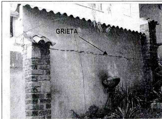
Fotografía No. 3 Se observan las grietas de tendencia horizontal, en el tramo de muro de cerramiento, localizado al costado nor oriental del predio de la Carrera 92 No. 150 - 70, donde se emplaza el Centro de Recepciones conocido como Casa El Retorno.
