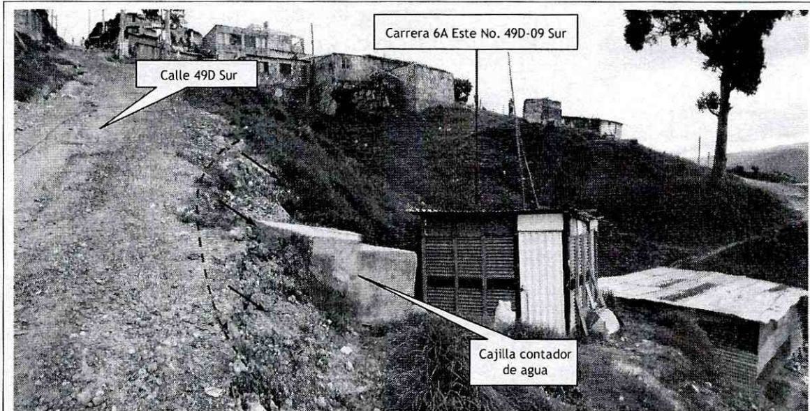
Foto 1. Vista panorámica del predio con nomenclatura Carrera 6A Este No. 49D-09 Sur del Barrio San Martín de la Localidad de Rafael Uribe Uribe, donde se evidencia una grieta de tracción que delimita un posible proceso de remoción en masa activo de carácter local y que involucra un volumen adicional aproximado de 5 m3 y que generó el desconfinamiento de la cajilla del medidor del agua.
