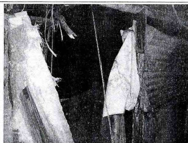
Foto 1 afectaciones presentadas sobre las viviendas evaluada, las cuales comprometen su estabilidad y habitabilidad
