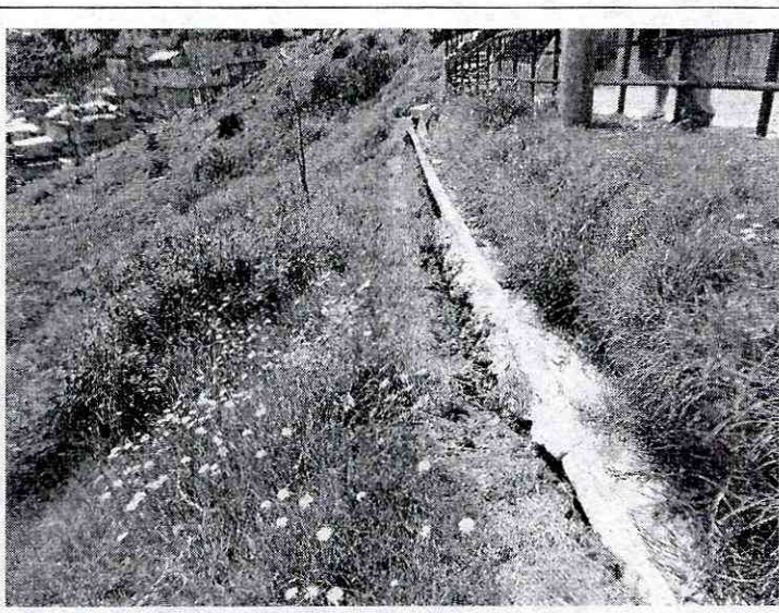
Fotografía 6. Grieta de tracción identificada sobre la corona del talud, paralela a la cuneta en concreto implementada posiblemente para el manejo de las aguas de escorrentía (Foto tomada el 16 de Diciembre de 2011)
