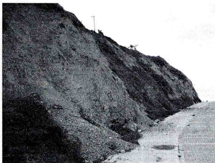
Fotografía 2. Vista de los pequeños desprendimientos evidenciados que no alcanzan 1m³ de volumen (Foto tomada el 9 de Diciembre de 2011)
