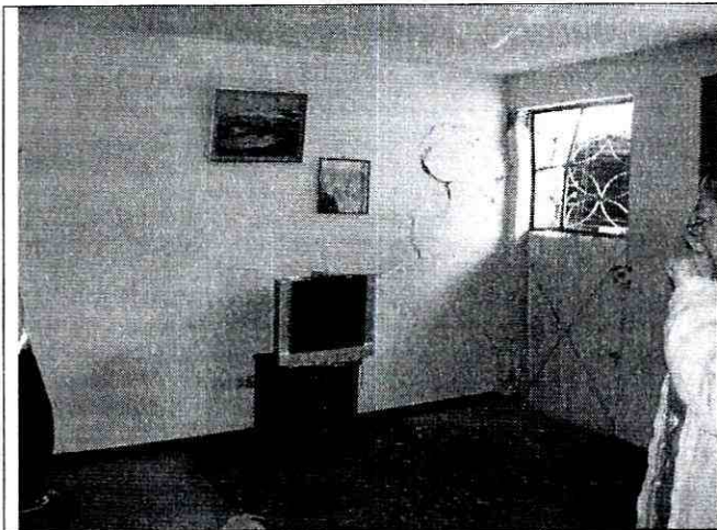
Foto 3. Afectaciones en el muro de cerramiento del costado norte de una de las viviendas afectadas.
