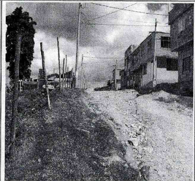
Foto 11. Vista de la vía que se encuentra en la parte alta de la ladera, se aprecia que no se encuentra pavimentada y que no cuenta con sistemas para el manejo de la escorrentía superficial
