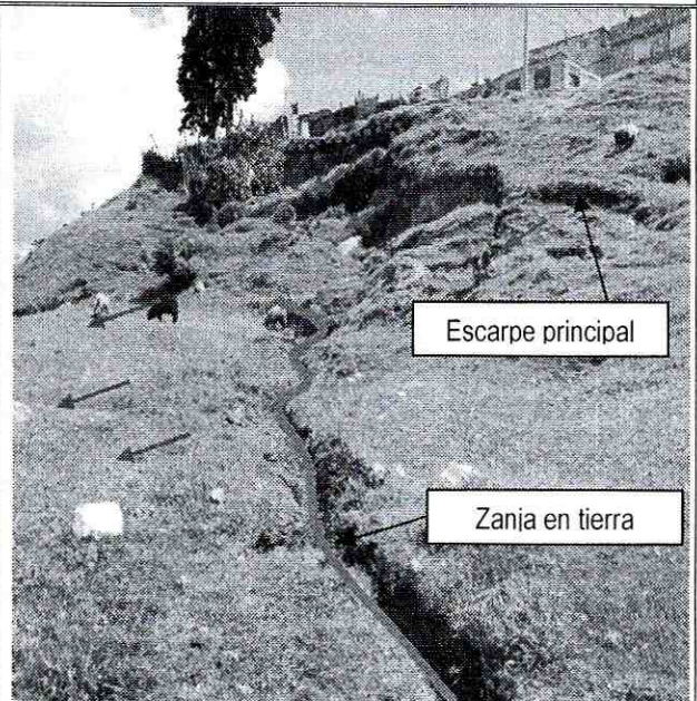
Foto 9. Imagen donde se observa el escarpe principal del proceso ubicado en la parte alta de la ladera, de igual manera se observa una zanja en tierra elaborada posiblemente por los responsables del predio para manejo de aguas.
