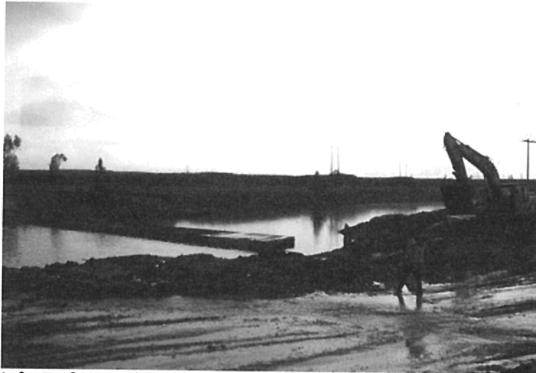
Foto 3. Construcción de la cámara norte del box coulvert que atraviesa el canal Cundinamarca.
