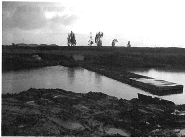
Foto 8. Canal Cundinamarca con altos niveles, construcción del box coulvert y descarga Villa Alsacia
