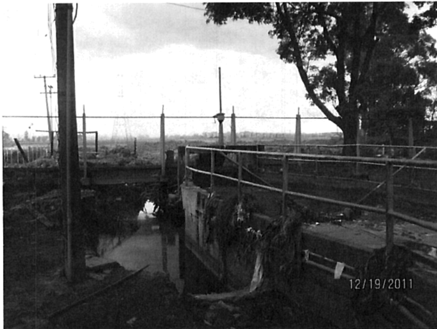
Foto 37. Compuerta antireflujo estación elevadora Fontibón, tomada el 19 de diciembre 2011
