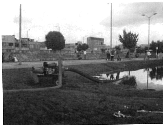
Foto 34. Bombeo localizado desde el conjunto residencial Alameda a un predio adyacente al Canal Cundinamarca
