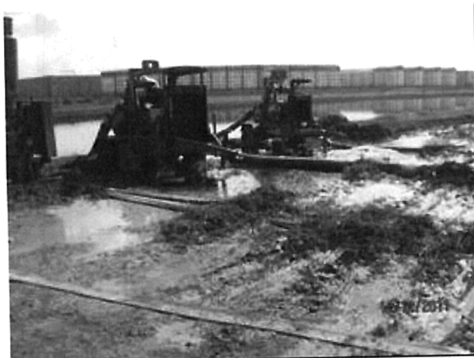
Foto 33. Bombeo desde el Canal Cundinamarca hacia el predio el Corso
