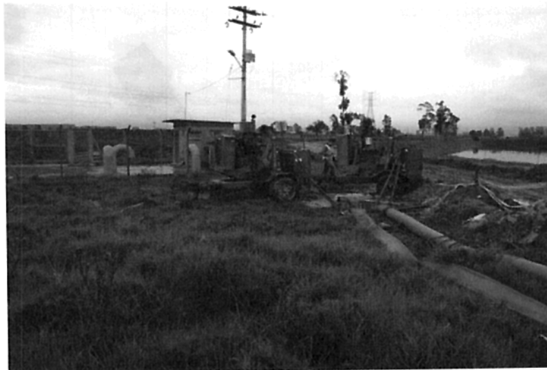
Foto 6. Bombas para evacuación de aguas del túnel hacia el Canal Cundinamarca.
