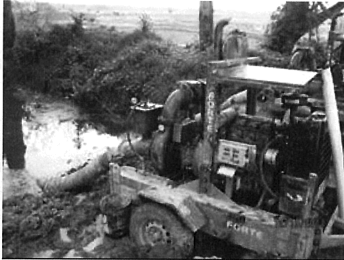
Foto 35. Bombeo desde el canal de descarga de la estación elevadora de Fontibón hacia el río Fucha
