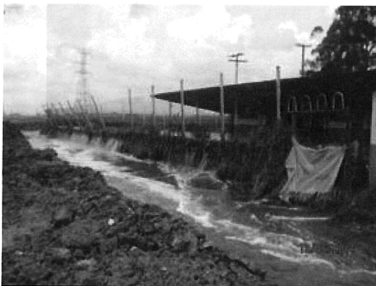
Foto 18. Inundación de la estación elevadora Fontibón y vertimiento al canal Cundinamarca a través del cerramiento
