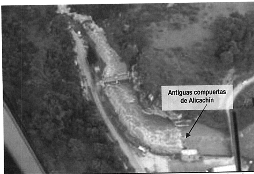
Foto 16. Control hidráulico de las antiguas compuertas de Alicachín sobre el río Bogotá
