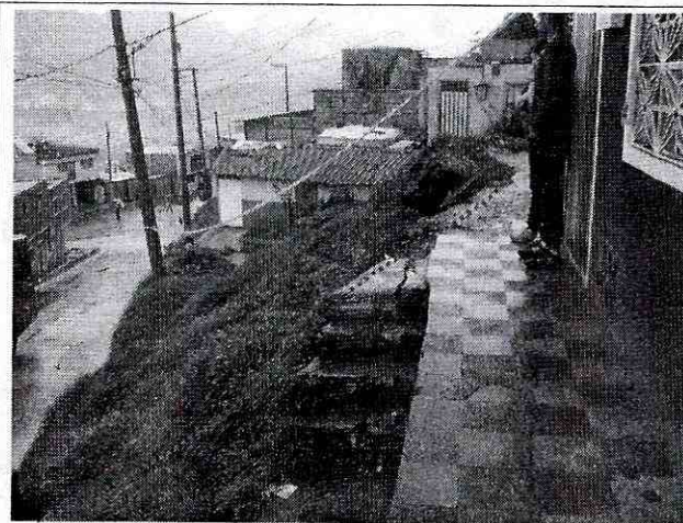
Foto 3. Vista de la parte alta del talud de corte, donde se observa que el escarpe del proceso de remoción en masa identificado, se localiza en el sendero peatonal a la altura del predio con nomenclatura Carrera 20 No. 70N-15 Sur del Barrio Villas del Progreso de la Localidad de Ciudad Bolívar.
