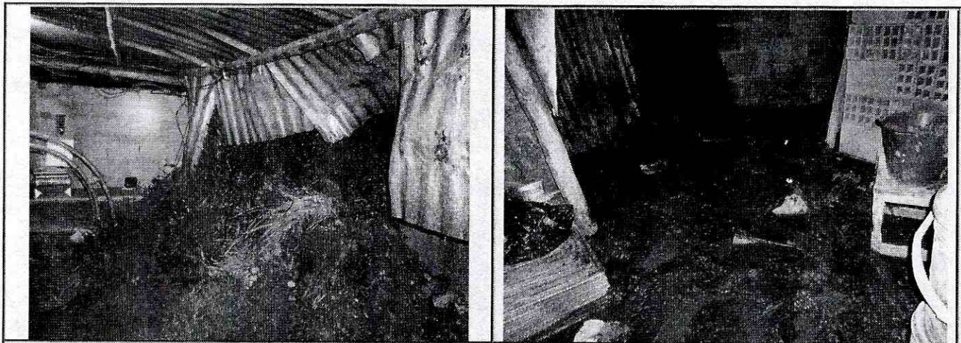
Fotografías No. 3 y 4. Vista al interior de la vivienda emplazada en el predio de la Carrera 4 Este # 163A-73 IN. 2, la cual presentó colapsos parciales debido al proceso de remoción en masa evidenciado.
