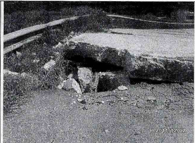
Foto 4. Detalle del colapso parcial de la estructura del pavimento rígido, producto de la actividad del proceso de remoción en masa.
