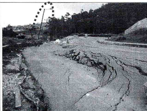
Foto 2. Vista hacia el norte de las deformaciones causadas por el desplazamiento de la masa inestable, que afecta la capa de asfalto instalada en el sector y detalle de la afectación de la infraestructura pública.
