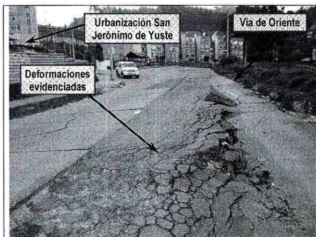
Foto 1. Vista hacia el sur de las deformaciones causadas por el desplazamiento de la masa inestable, que afecta la capa de asfalto instalada en el sector.
