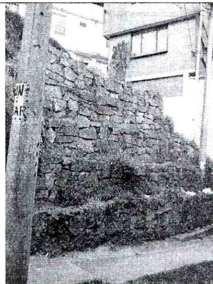
Foto 2. Obra de contención tipo Gavión localizada al costado sur-oriental de la zona verde evaluada.
