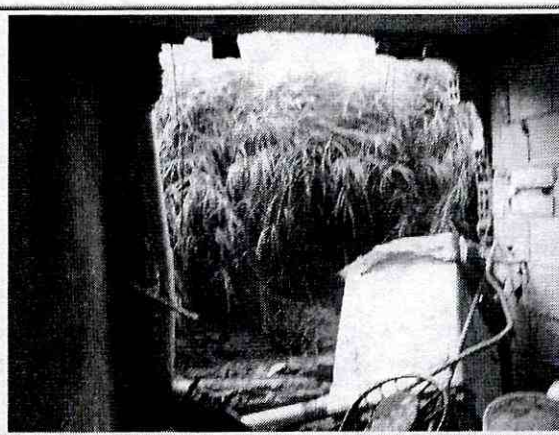
Foto 2. Evidencia de colapso parcial del muro en mampostería parcialmente confinada, en el talud de corte ubicado al costado occidental del predio ubicado en Carrera 45 A No 76 B - 17 Sur
