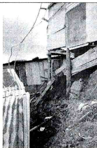
Foto 2. Desprendimiento de material presentado en el talud de corte existente entre los inmuebles Carrera 15 No. 78 C-44 Sur (Casa 1) y Carrera 15 No. 78 C-44 Sur (Casa 2)
