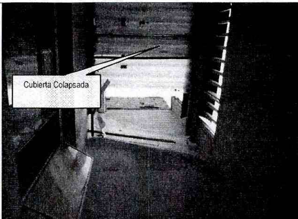
Foto 4. Vista de la cubierta de segundo nivel, en la zona posterior de la edificación emplazada en el predio de la Calle 130 C Bis No. 95 B-28, donde se observa el colapso de teja traslúcida, por impacto de bloques de arcilla desprendidos del muro del edificio vecino.
