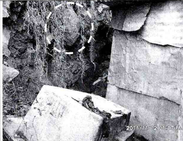
Foto 4. Se observan bloques de gran tamaño con riesgo de caída y posibilidad de impacto a la vivienda.
