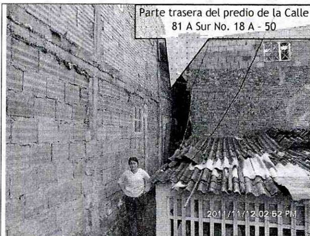
Foto 1. La afectación se presenta en la parte trasera del predio de la Calle 81 A Sur No. 18 A - 50, barrio El Minuto de María en la localidad de Ciudad Bolívar
