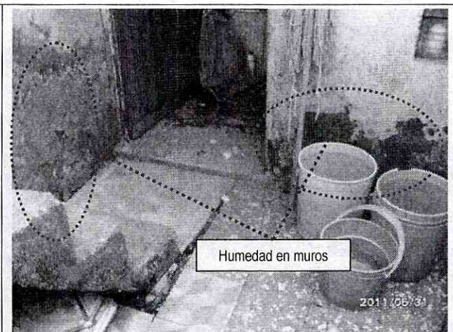
Foto 3. Se observa humedad en los muros del primer nivel de la vivienda emplazada en el predio con nomenclatura Calle 8A Sur No. 11D-20 Este.
