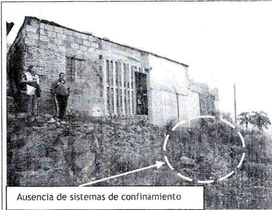
Fotografía No. 2. Se observa la ausencia de un sistema de confinamiento en el relleno implementado para el emplazamiento de la vivienda, al costado Nor - Occidental de la Vivienda de la Calle 86C No. 17 - 15 Este
