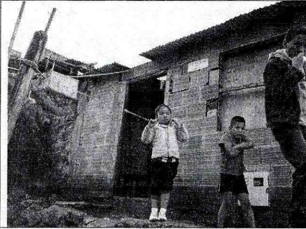
Foto 1. Vista general de la vivienda ubicada en la Carrera 26G # 72 G -27 Sur. Se presentan deficiencias constructivas, relacionadas con la carencia de elementos de confinamiento y amarre de tipo vigas y columnas.
