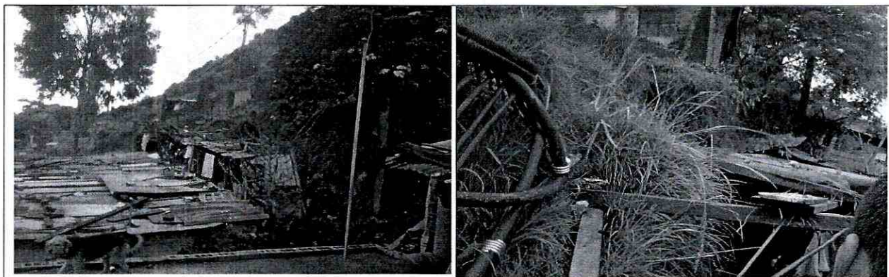
Fotografía No.3, 4. Detalle fallas del talud de corte de la vivienda emplazada en el predio Diagonal 40 B Bis Sur No.2 K-16 (Manzana 69 Lote 2)
