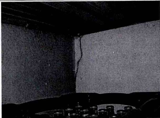
Foto 12. Se observan las grietas de tendencia vertical sobre los muros divisorios ubicados en el costado norte del restaurante piqueteadero de la del supermercado ubicado en la Calle 189 No.7A-10. (Fotografía 5 de octubre de 2011)
