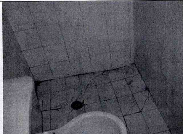
Foto 13. Se observan las grietas de sobre la placa de contrapiso del baño ubicado en el costado norte del restaurante piqueteadero de la Calle 189 No.7A-10. (Fotografía 5 de octubre de 2011)
