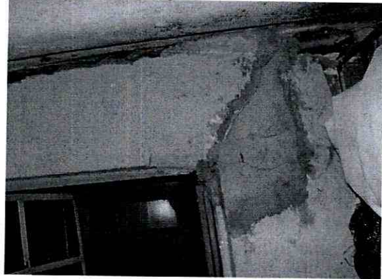
Foto 11. Se observan las grietas de tendencia diagonal sobre los muros divisorios ubicados en el costado norte del restaurante piqueteadero de la Calle 189 No.7A-10. (Fotográfica 5 de octubre de 2011)
